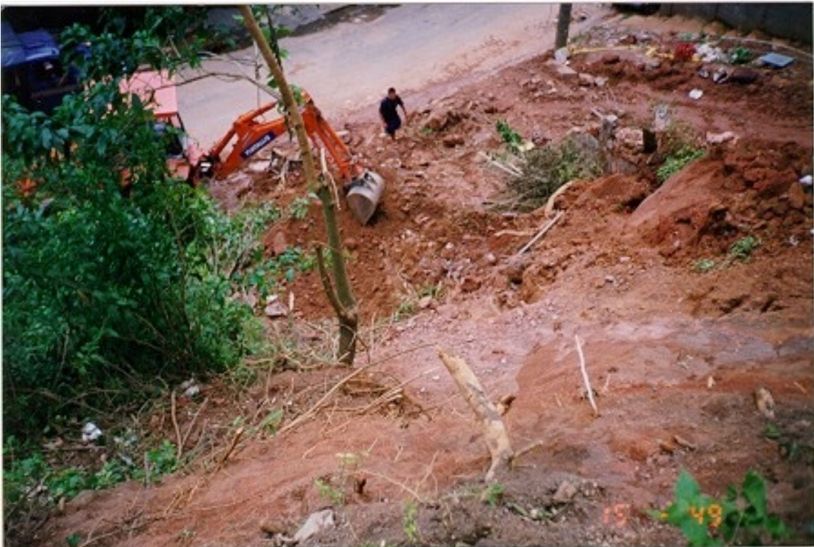
Foto 1 - Deslizamento em solo residual (visto de montante) Morro da Formiga - Rio de Janeiro
